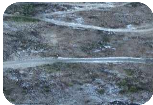
KM 5+700 FRANA ESINA VALLE
