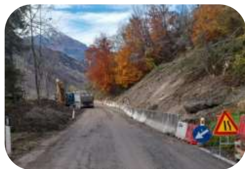
KM 5+700 FRANA ESINA MONTE
