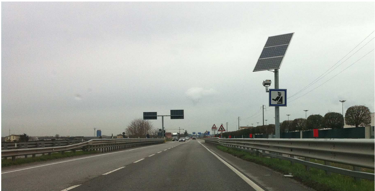
Postazione di controllo - telecamera - km 47+841
