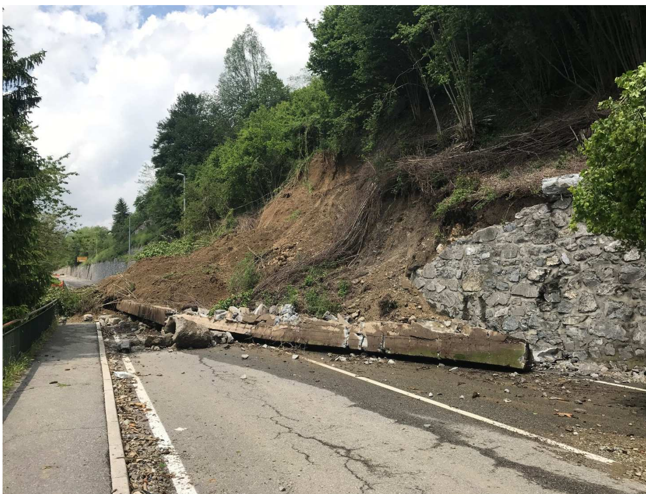
Fig. 1 – Frana – In primo piano il cordolo del muro esistente crollato
