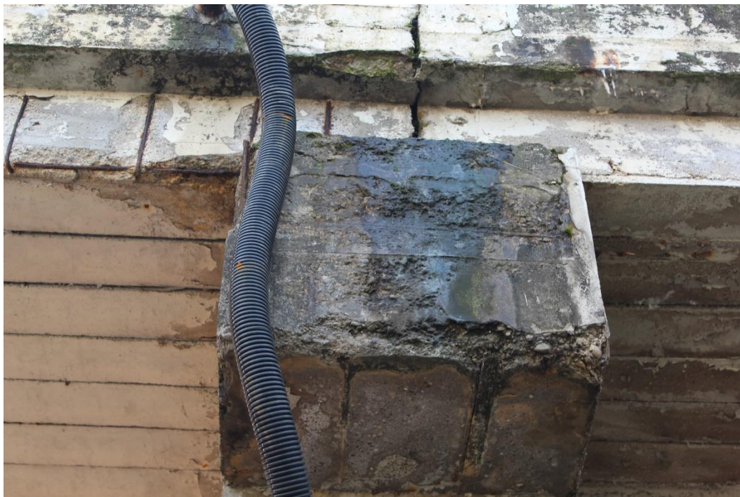
Figura 92: Manufatto BSSPEXSS45B_P001: trave T1 (mensola).
