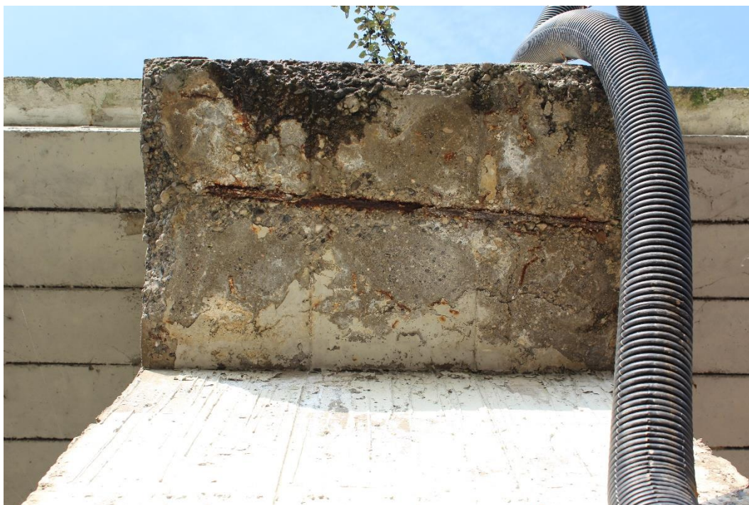
Figura 87: Manufatto BSSPEXSS45B_P001: trave T1 (mensola).
