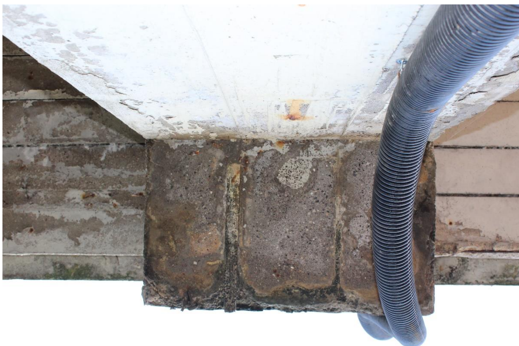
Figura 91: Manufatto BSSPEXSS45B_P001: trave T1 (mensola).
