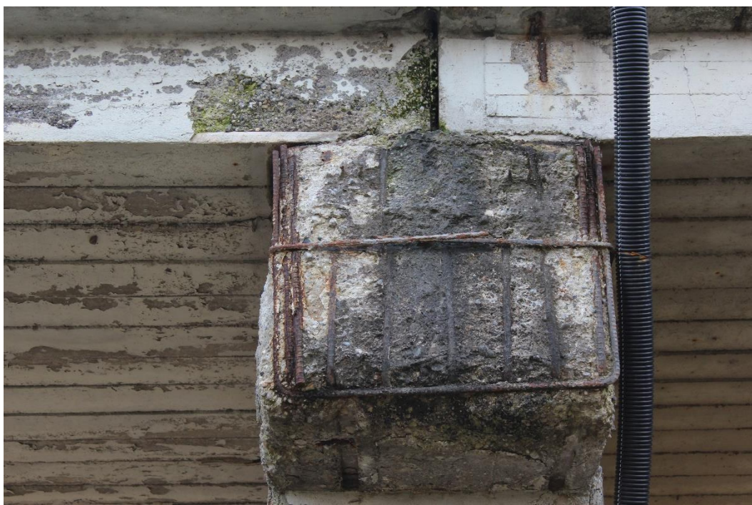
Figura 42: Manufatto BSSPEXSS45B_P004: trave T2 (mensola).
