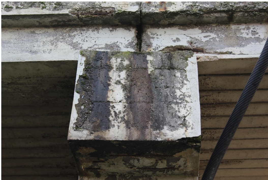
Figura 29: Manufatto BSSPEXSS45B_P004: trave T1 (mensola).
