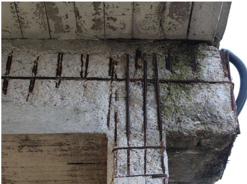
Figura 41: Manufatto BSSPEXSS45B_P004: trave T2 (mensola).
