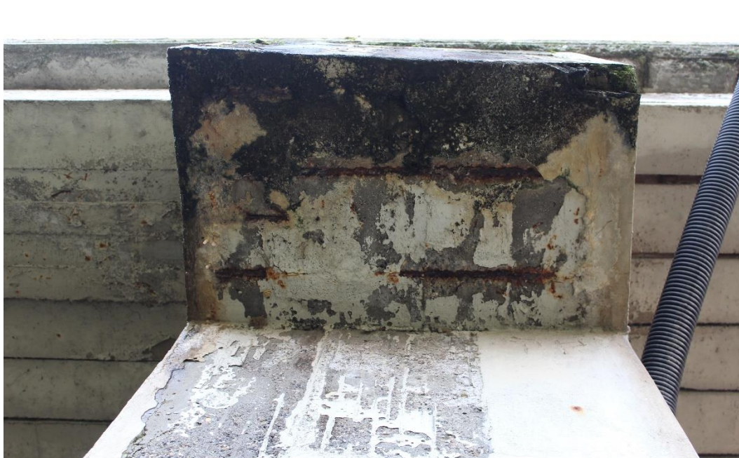
Figura 30: Manufatto BSSPEXSS45B_P004: trave T1 (mensola).
