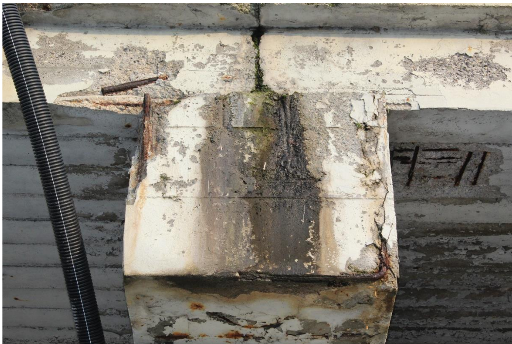
Figura 35: Manufatto BSSPEXSS45B_P004: trave T1 (mensola).
