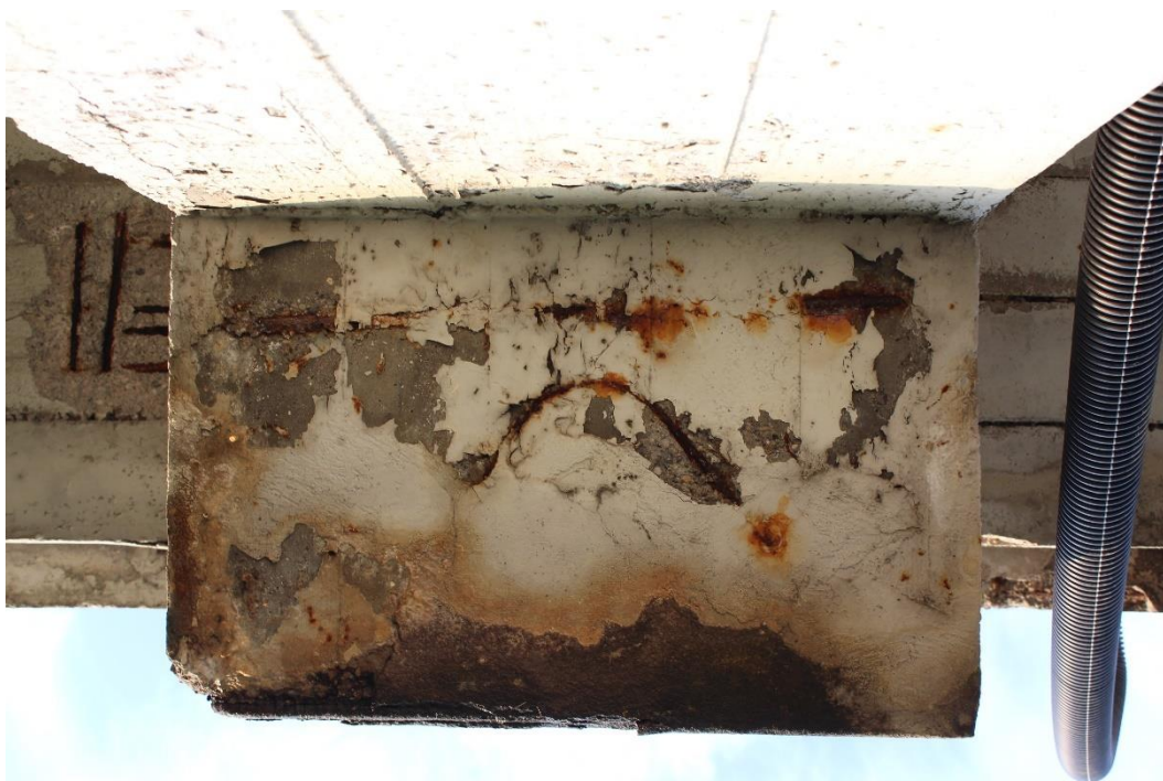
Figura 34: Manufatto BSSPEXSS45B_P004: trave T1 (mensola).
