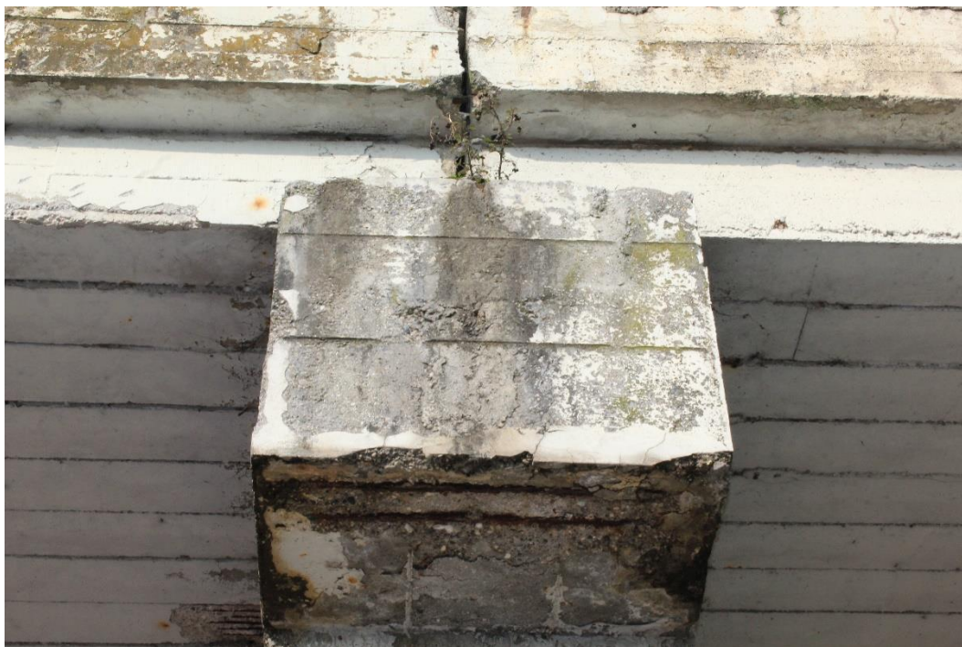
Figura 93: Manufatto BSSPEXSS45B_P001: trave T2 (mensola).
