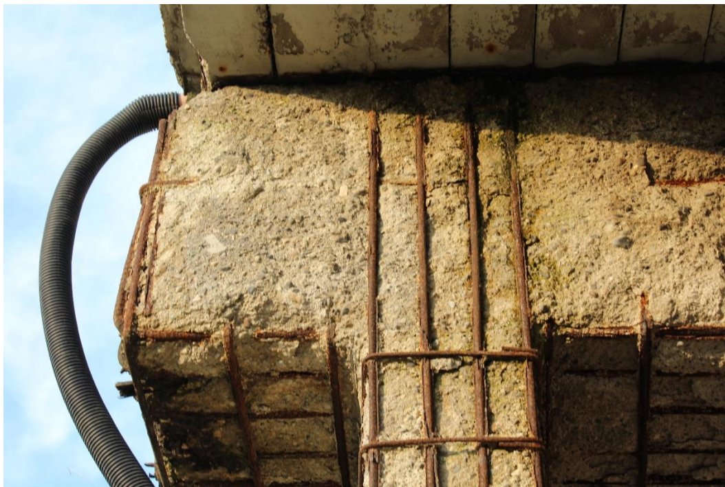
Figura 37: Manufatto BSSPEXSS45B_P004: trave T2 (mensola).
