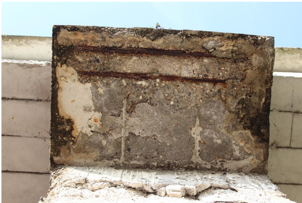
Figura 94: Manufatto BSSPEXSS45B_P001: trave T2 (mensola).
