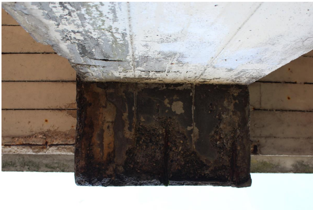
Figura 98: Manufatto BSSPEXSS45B_P001: trave T2 (mensola).
