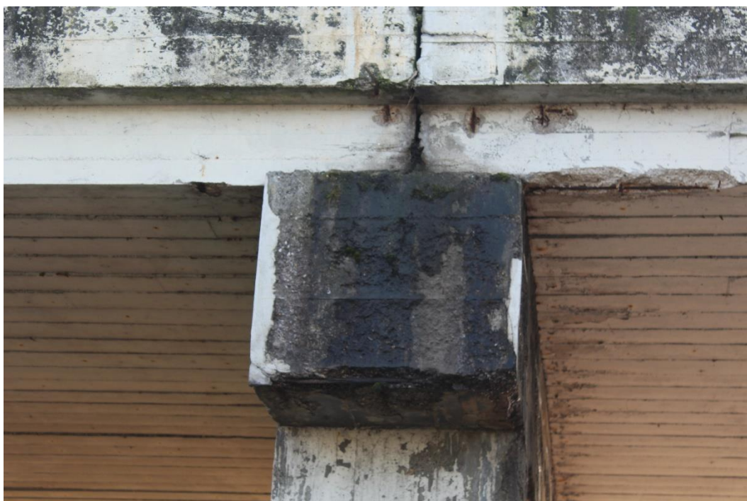
Figura 99: Manufatto BSSPEXSS45B_P001: trave T2 (mensola).
