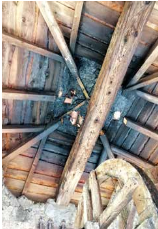
Gli effetti dell'incendio - i travetti decapitati e alcune tegole che si intravedono attraverso i resti del legno bruciato
